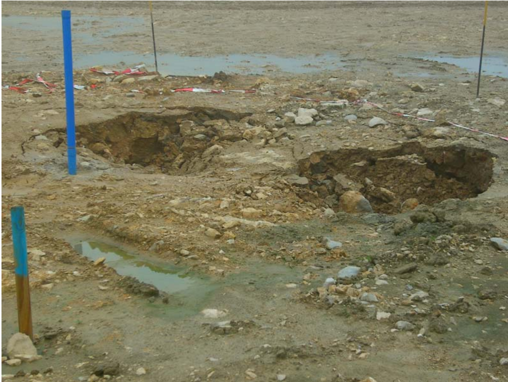
Bild 25: Aufnahme vom 21.07.2011, Nachbrüche am verfüllten Einbruch 7
