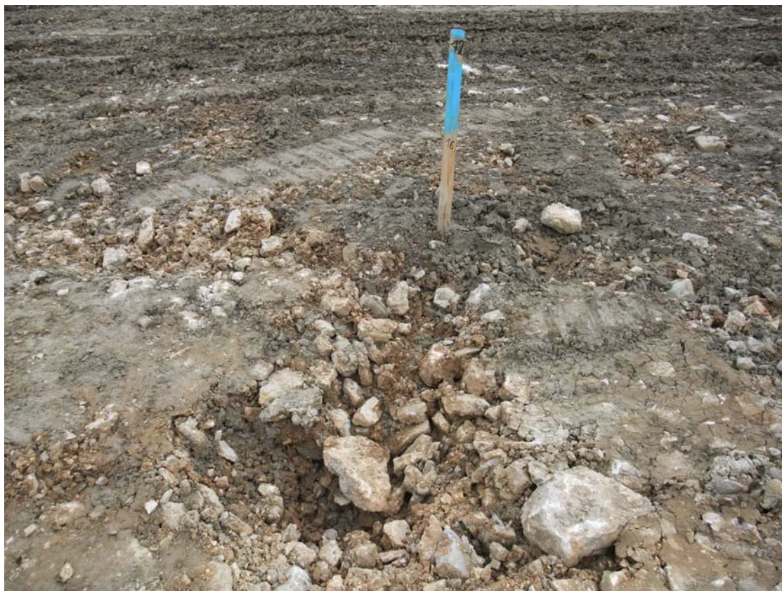
Bild 24: Blick am 28.04.2011, 17:08 Uhr, von Norden auf den neuen Einbruch 16
