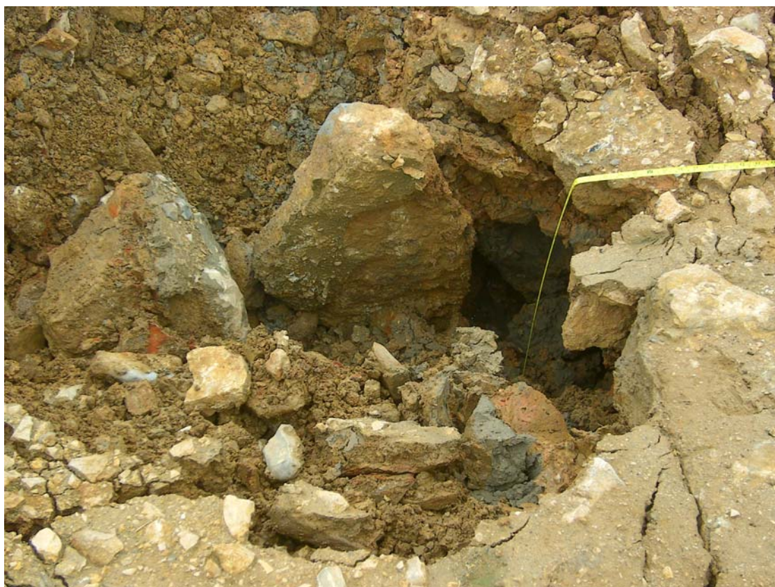
Bild 27: Aufnahme vom 21.07.2011, Nachbrüche am verfüllten Einbruch 7
