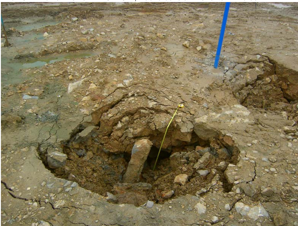
Bild 26: Aufnahme vom 21.07.2011, Nachbrüche am verfüllten Einbruch 7
