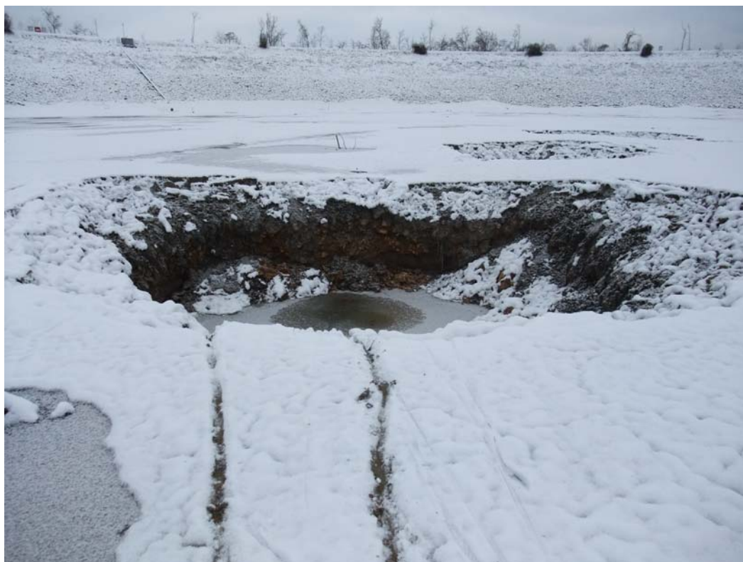
Bild 12: Einbruch 5, Aufnahme vom 21.01.2011
