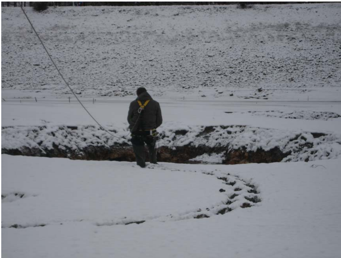
Bild 6: Erstbegutachtung des Einbruchs 1 am 21.01.2011
