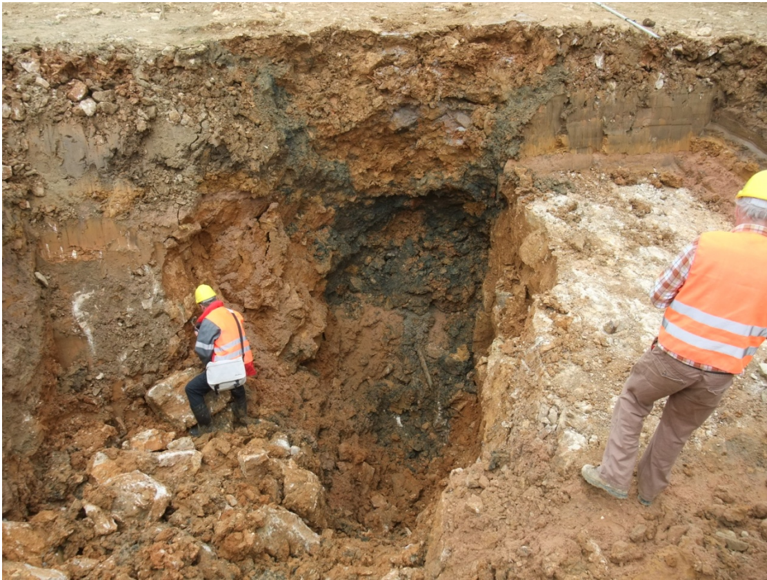
Bild 7.12 Einbruchtrichter 7: Lockergesteine mit Kalksteinen und –brocken im Kontakt zu einer nahezu vertikalen, stark geklüfteten Kalksteinformation (rechts), im Einsturzbereich tiefreichende weiche schwarze Sedimente (Mitte)
