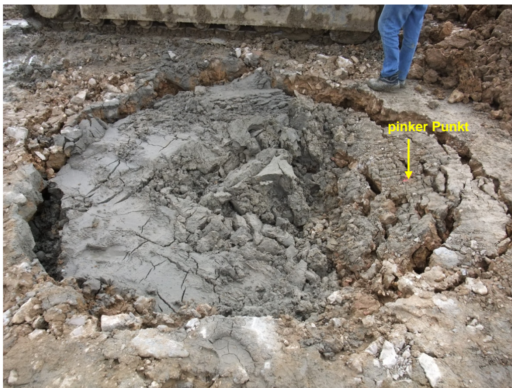
Bild 23: Blick am 29.04.2011, 09:11 Uhr, von Süden auf den neuen Einbruch 17
