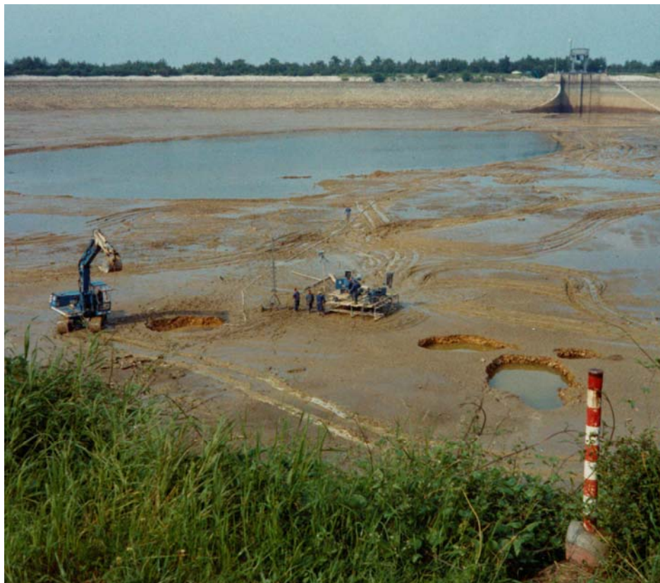
Bild 5.5: Einbruchstellen und Sanierungsarbeiten am 26.07.1974
