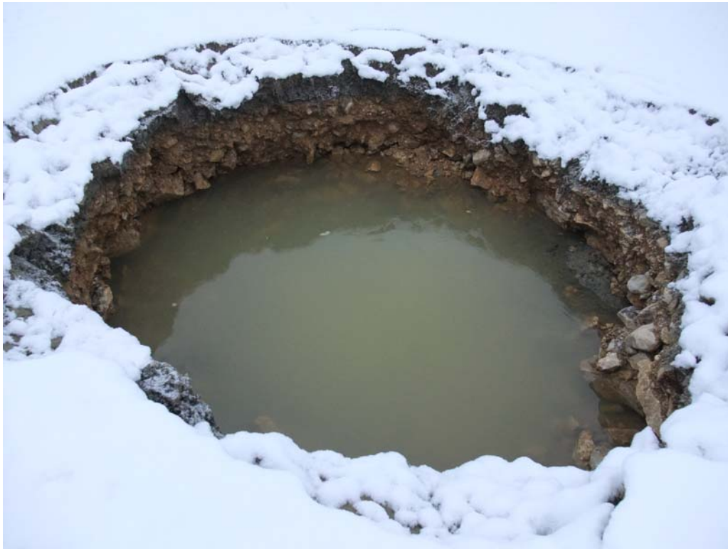
Bild 8: Einbruch 6, Aufnahme vom 21.01.2011
