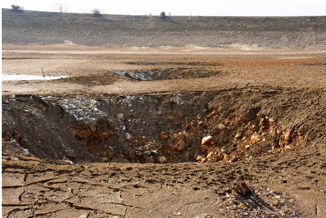
Bild 18: Aufnahme vom 01.03.2011, Einbruch 5
