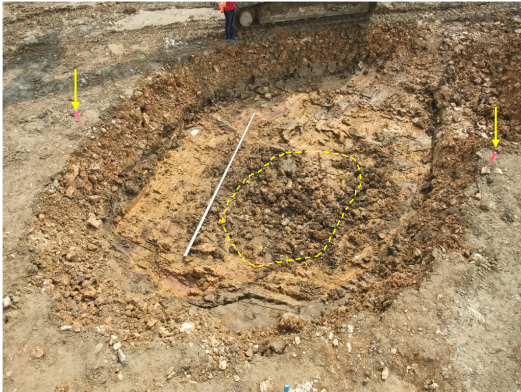
Bild 11: Blick von Nordwesten auf Einbruchtrichter nach Abräumen der Lehmdichtung aus Tallehm, außerhalb des Einbruchtrichters unterliegender Lehm aus Oberbecken, im Einbruchtrichter eingebrochenes Schutzschichtmaterial
