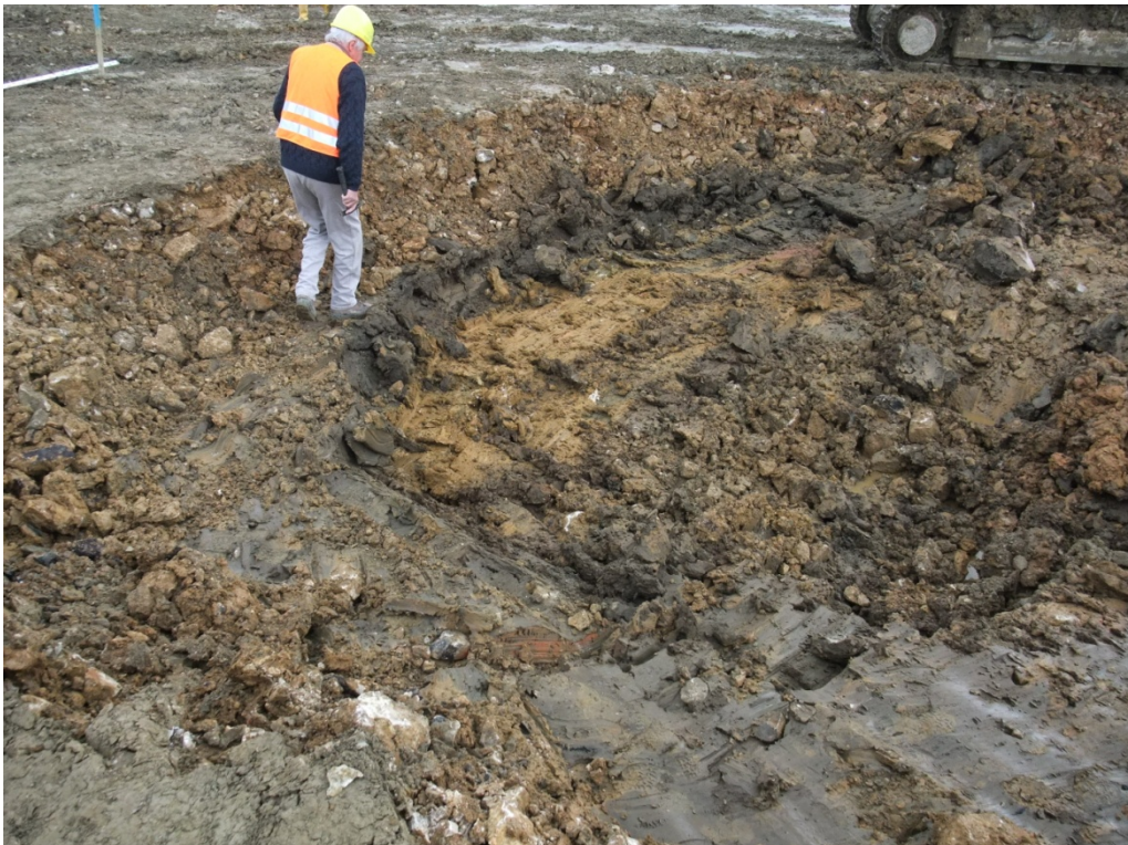
Bild 10: Beginn Abräumen der Lehmdichtung aus Tallehm (dunkelgrau), darunter Lehm aus Oberbecken (ocker) erkennbar
