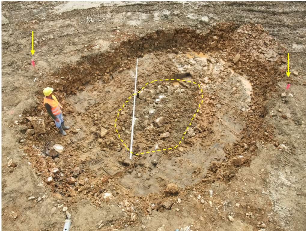
Bild 7: Blick von Nordwesten auf Einbruchtrichter nach Abräumen der Schutzschicht außerhalb des Einbruchtrichters Lehmdichtung aus Tallehm (homogen, ohne Schadstelle, steif), im Einbruchtrichter eingebrochenes Schutzschichtmaterial
