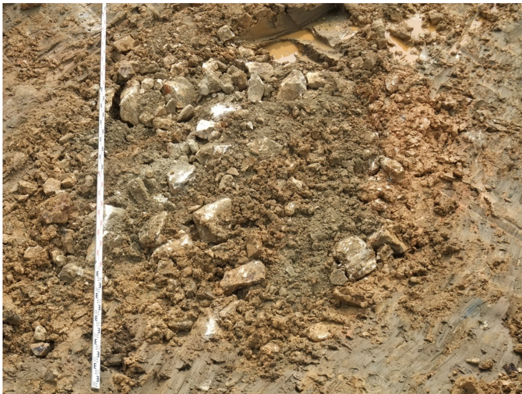
Bild 8: Detailaufnahme Einbruchtrichter nach Abräumen der Schutzschicht
