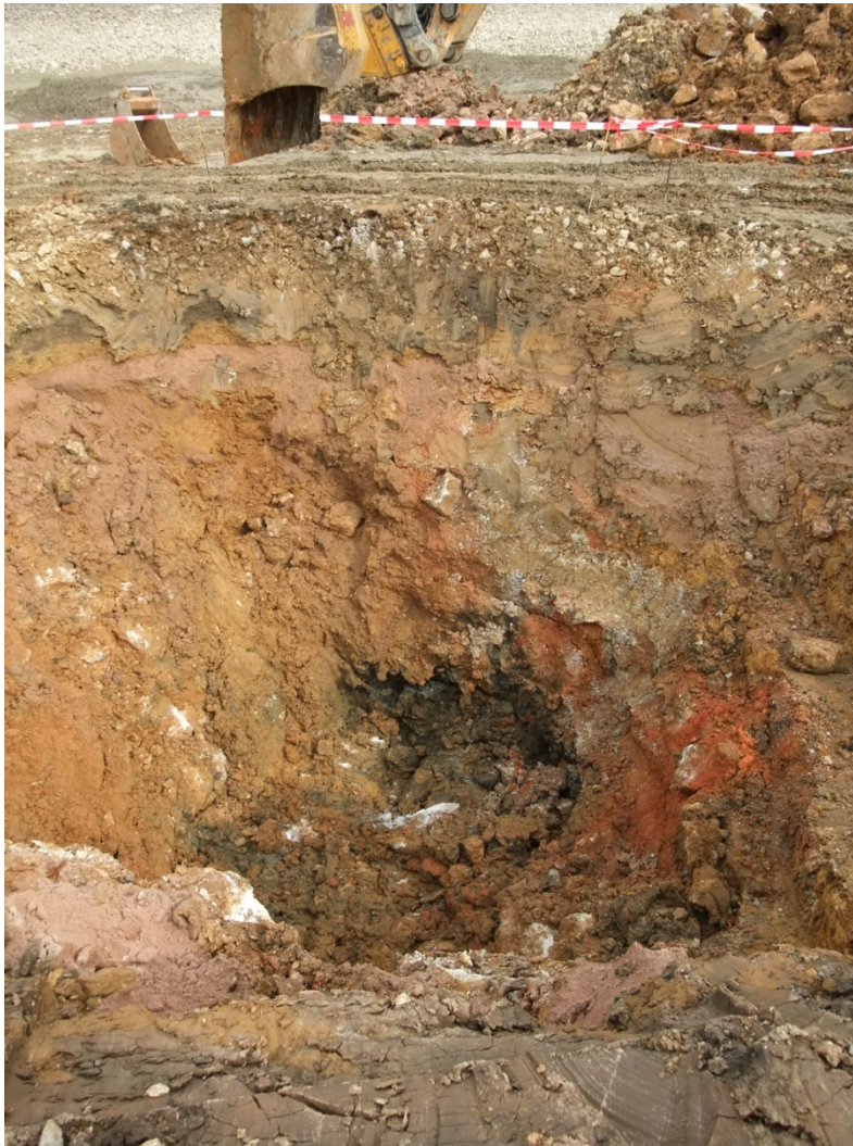
Bild 30: Aushub bis ca. -6 m, Blick in Schurf Richtung Nordosten: an der Basis des Einbruchtrichters unverändert dunkelgraues und schwarzes aufgeweichtes, tlw. breiiges bindiges Material vermutlich organischen Ursprungs (geringe Wichte) (Bekensediment?)
