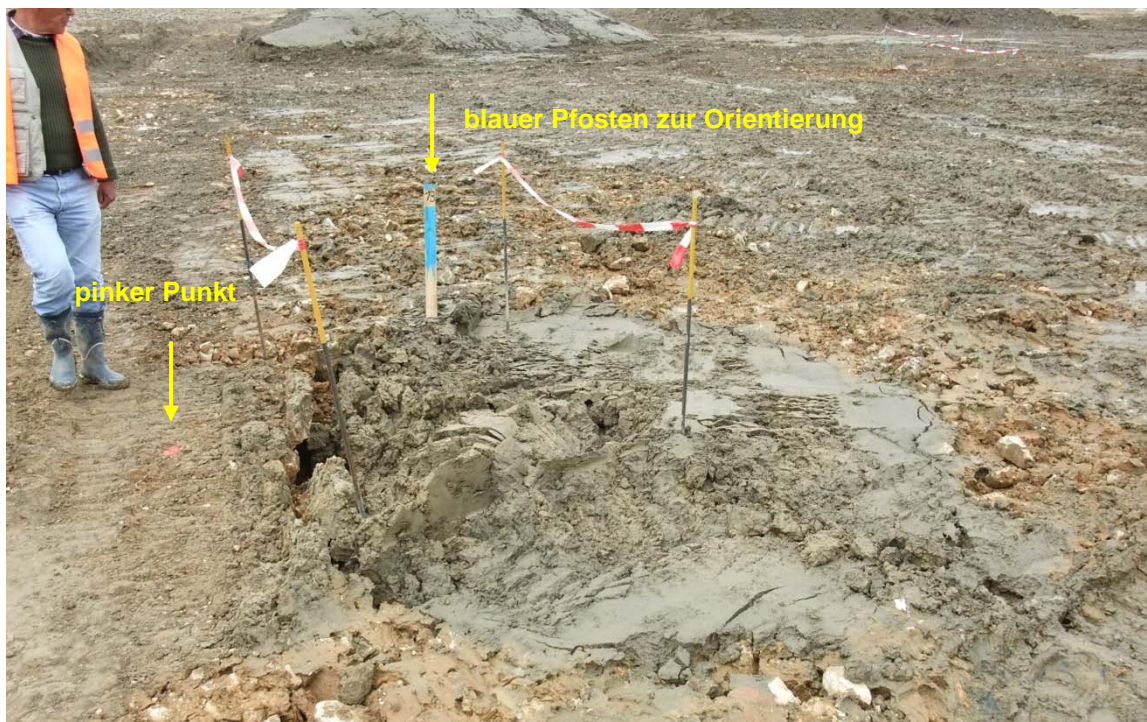
Bild 2: Blick am 27.04.2011 von Osten auf den neuen Einbruchtrichter 17
