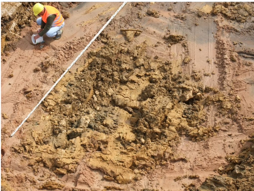
Bild 18: Detailaufnahme Einbruchtrichter nach Abräumen der Lehmschicht aus Oberbecken: eingebrochene Lehmdichtung (?) und Reste Schutzschicht
