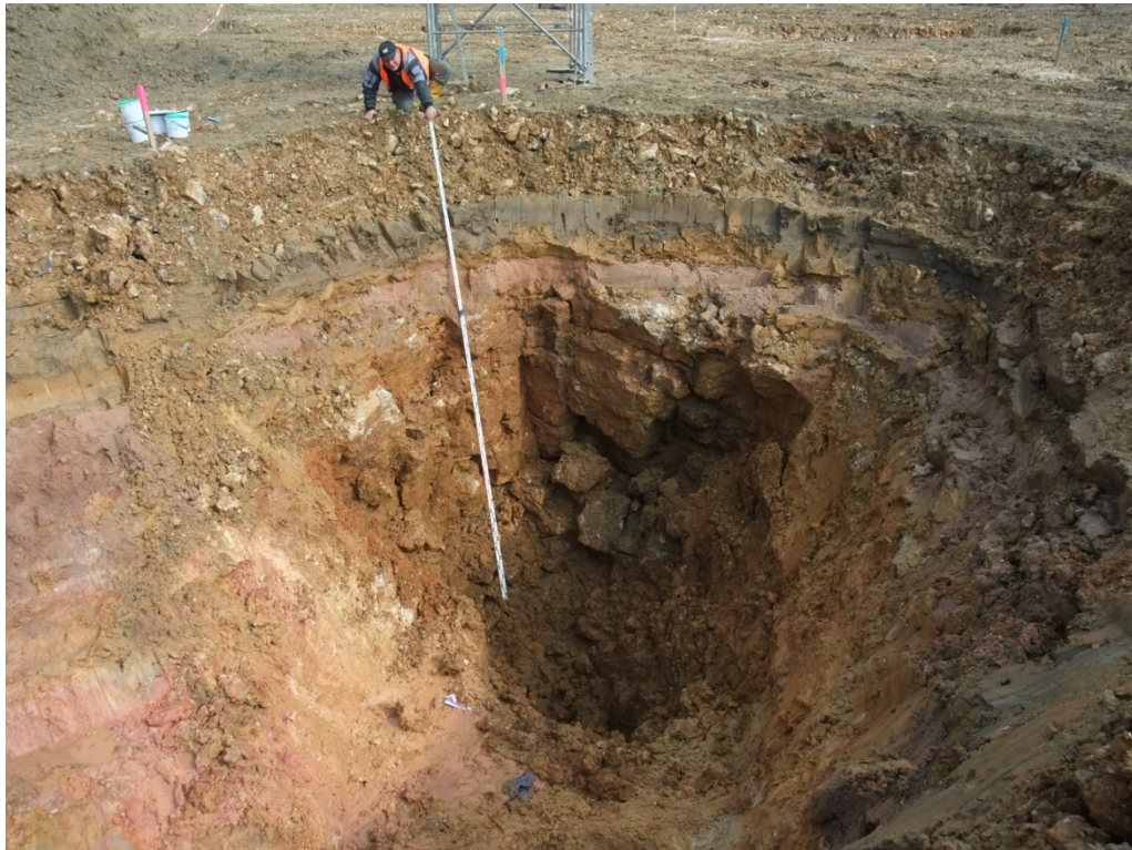
Bild 34: Aushub -5,5 m: an der Basis des Einbruchtrichters stehen weiter weiche Schluffe an
