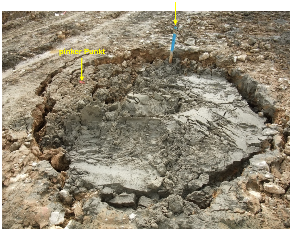
Bild 3: Blick am 28.04.2011 von Osten auf den neuen Einbruchtrichter 17
