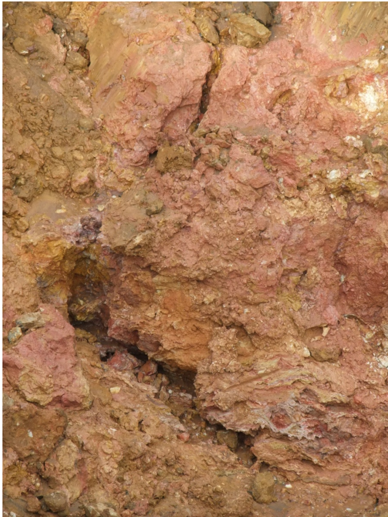
Bild 36: als Folge zusickernden Oberflächenwassers Erosionserscheinungen in den kreidezeitlichen Schluffen und Sanden der Störzonenfüllung nach zwei Tagen Standzeit (29.04.2011)
