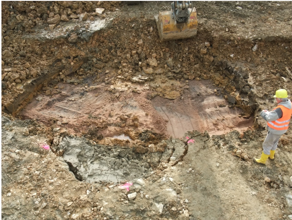
Bild 13: Blick von oben auf den einseitig bis zur Höhe des Filtersandes freigelegten Einbruchtrichter 17
