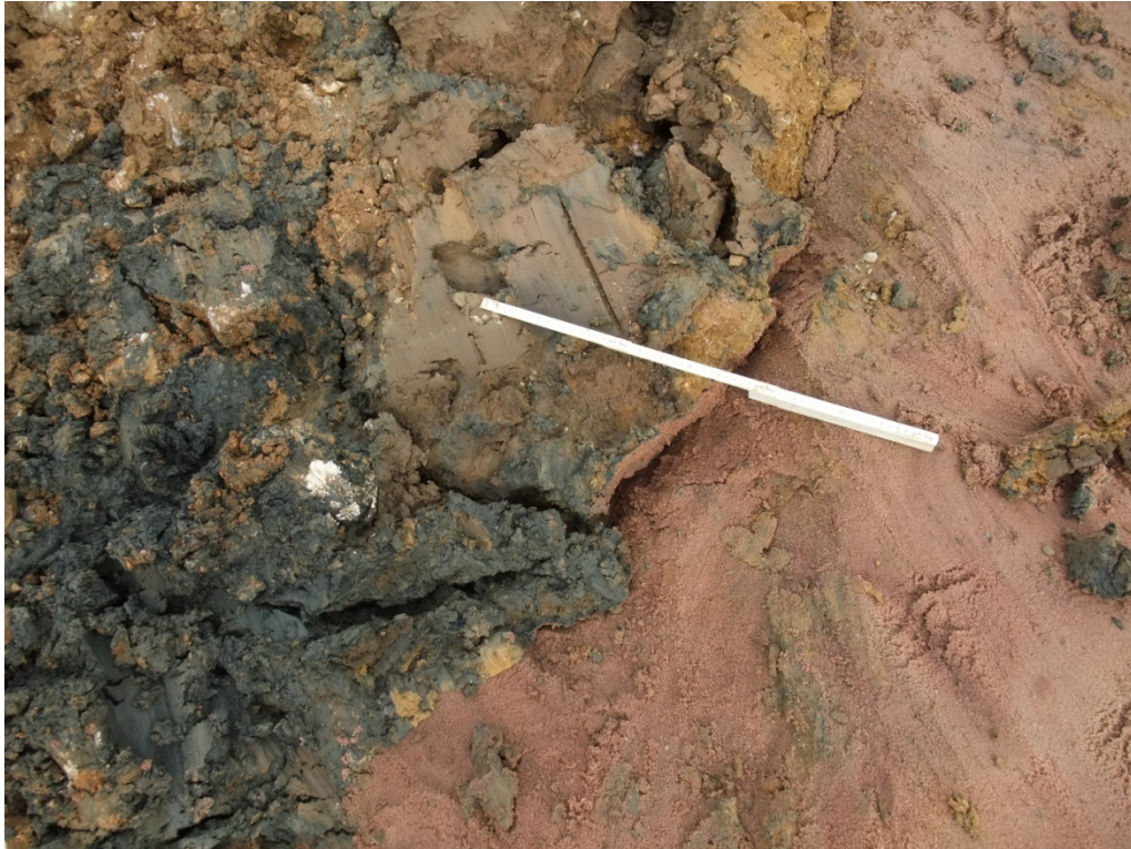
Bild 17: Detail Einbruchtrichter 3: scharfer Übergang zwischen eingebrochenen Beckensediment und Schutzschicht zu umgebenden Filtersand
