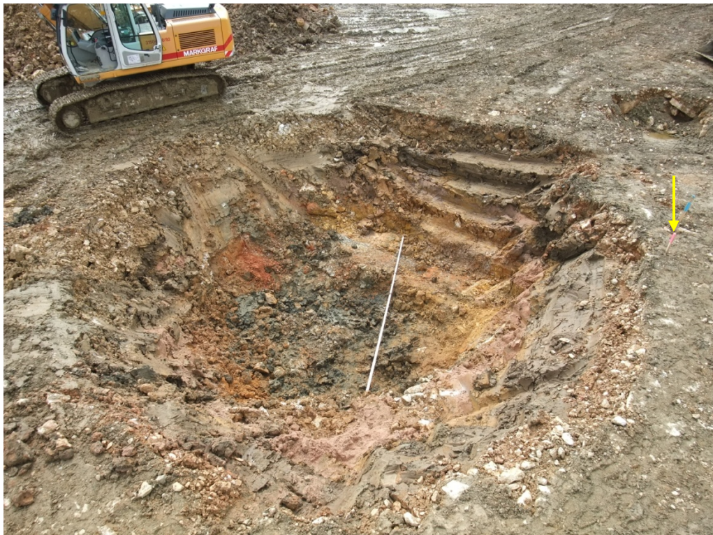
Bild 18: Blick von Nordwesten auf Einbruchtrichter 5 bei Aushubniveau -3,1 m, in Einbruchtrichter dunkelgraues aufgeweichtes Material
