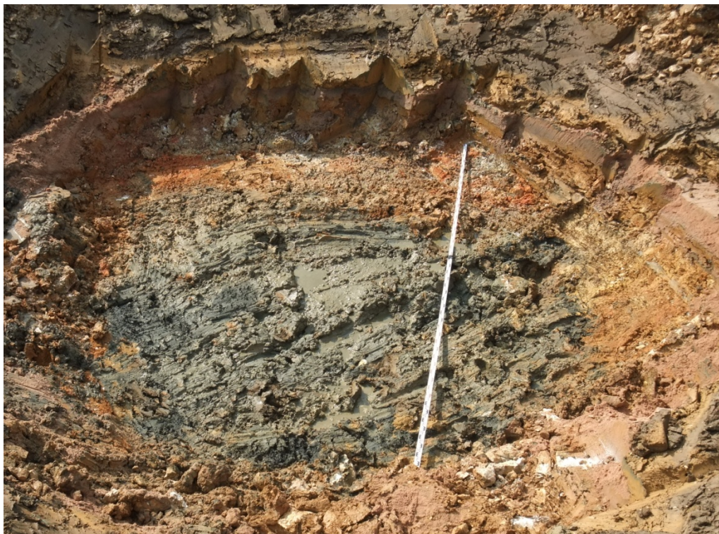
Bild 8: Detailaufnahme Einbruchtrichter (gefüllt mit breiigem dunkelgrauem, tlw. schwarzem bindigen, tlw. steinigem Material) nach Abräumen der Sohldichtung und von 0,5 m kreidezeitlichem Lockergestein
