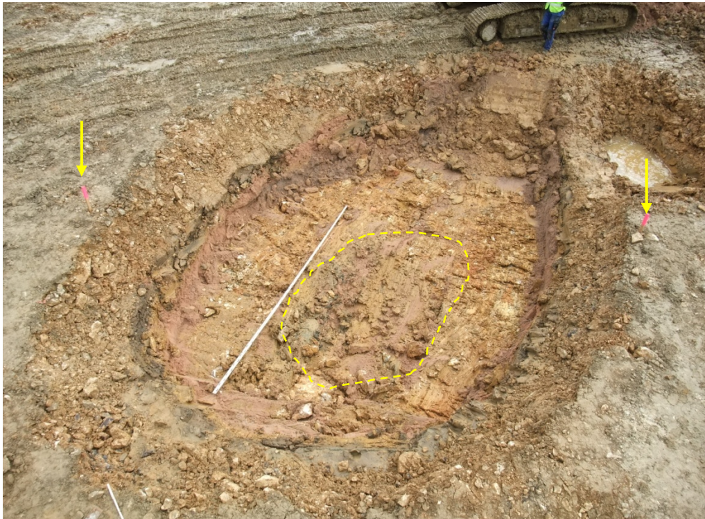
Bild 19: Blick von Nordwesten auf Einbruchtrichter nach Abräumen des Filtersandes, außerhalb des Einbruchtrichters unterliegender Schluff (kreidezeitliche Füllung Störzone, im Einbruchtrichter eingebrochenes Schutzschichtmaterial)
