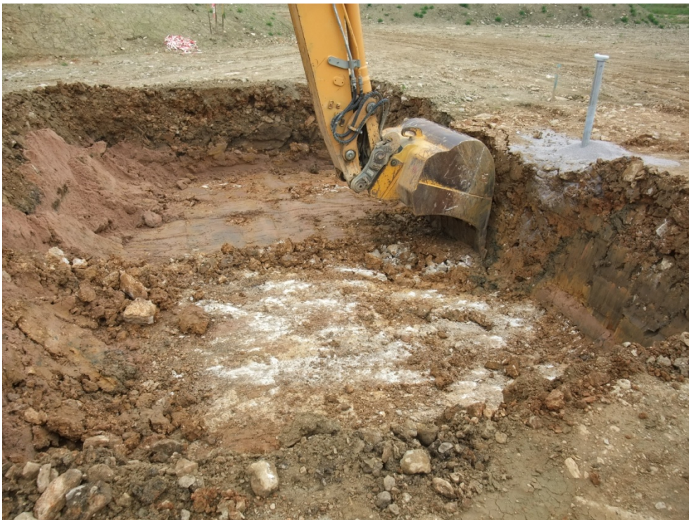
Bild 6: Schurf nach Abtrag des Drainagesandes, im östlichen Teil des Schurfes steht unmittelbar unter Drainagesand Kalkstein an
