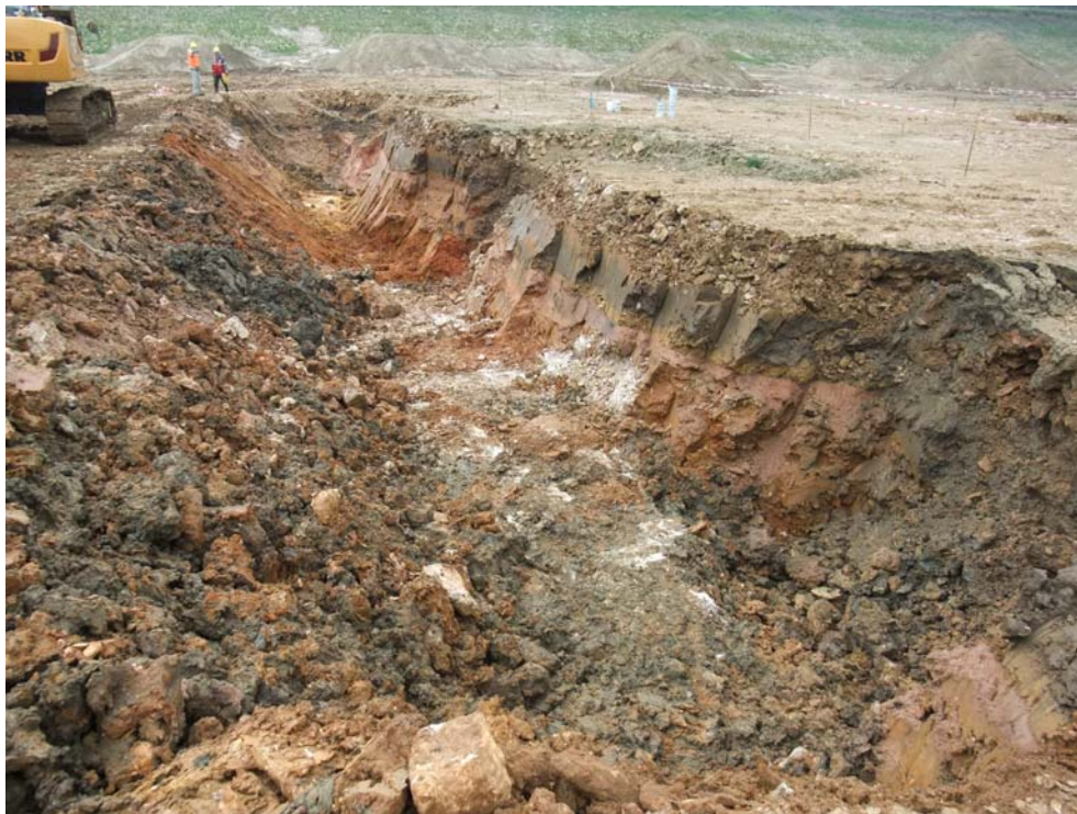
Bild 34: Blick von Nordosten in den Schurf bei Endaushub, im Vordergrund rechts Einbruch 4, zwischen Einbruch 2 und 4 Kalksteinformationen in verfüllter Versturzzone
