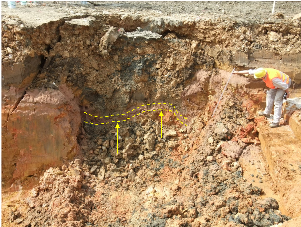
Bild 47: Aushub -3,4 m, Ansicht teilweise eingebrochener Einbruchtrichter 17 im Anschnitt: Filtersandschicht bei Einbruch 'verzogen', darunter kreidezeitliche Sedimente
