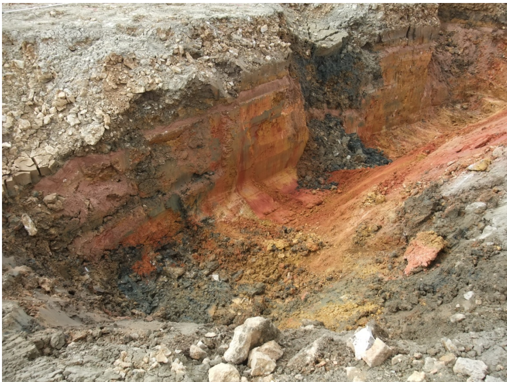
Bild 52: Vertiefung des Schurfs auf rd. 4,8 m: in Einbruchtrichter 1 unverändert schwarzes aufgeweichtes Material im Tiefsten
