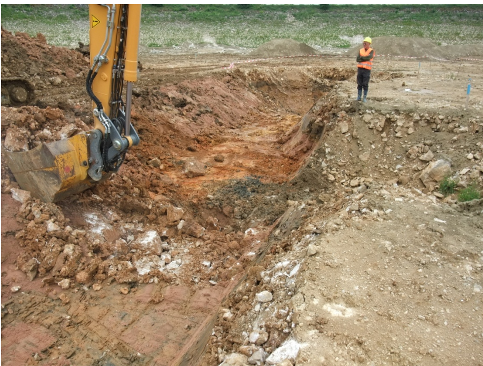
Bild 10: Blick von Südwesten: Antreffen einer räumlich begrenzten Kalksteinformation innerhalb der Lockergesteinsfüllung de Versturzzone, rechts Einbruch 2
