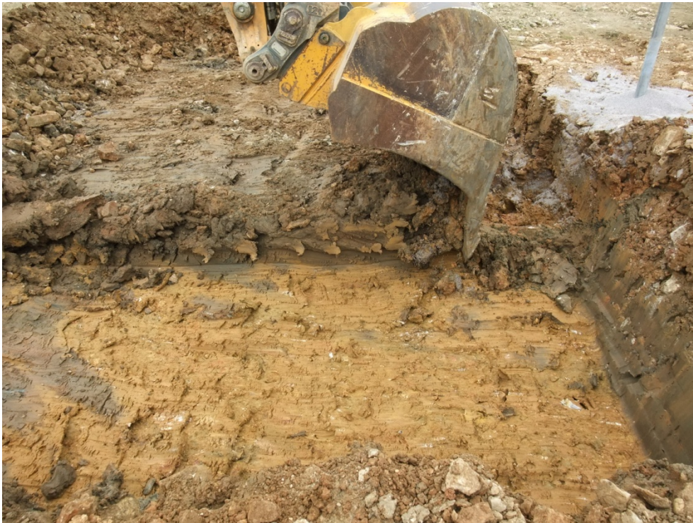
Bild 3: flächiger Abtrag der 'Lehmdichtung Tallehm', in der Basis der ockerfarbene 'Lehm aus dem Oberbecken'
