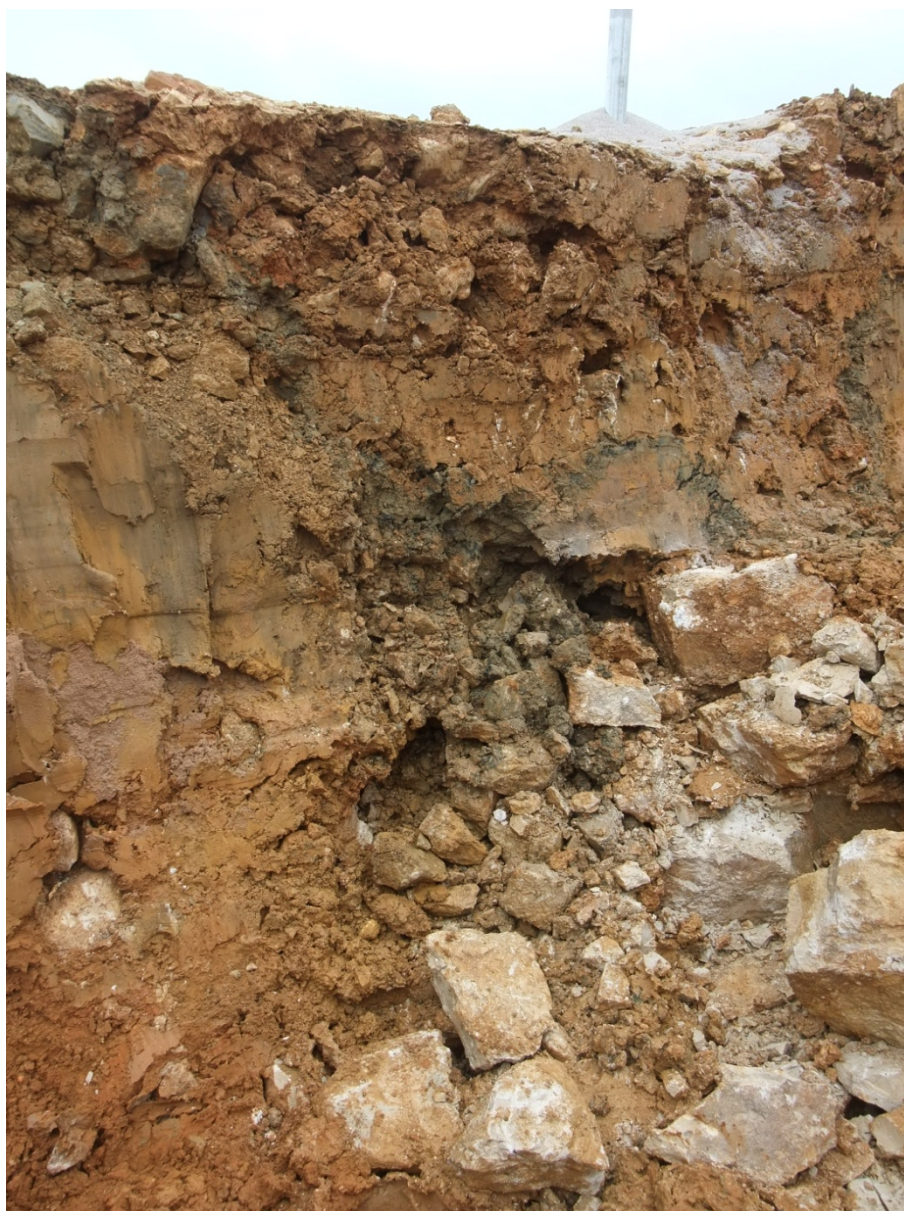
Bild 9: Einbruchtrichter 7 im Übergang einer Kalksteinformation zum Lockerstein; im Übergangsbereich eingelagerte Kalksteinblöcke
