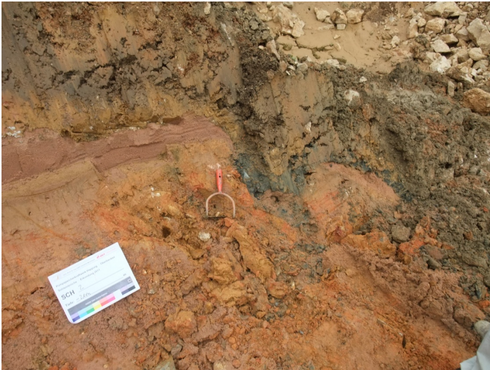
Bild 11: südwestlicher Rand des Einbruchtrichters 2: abgescherte Lehmdichtung mit Staffelbruch
