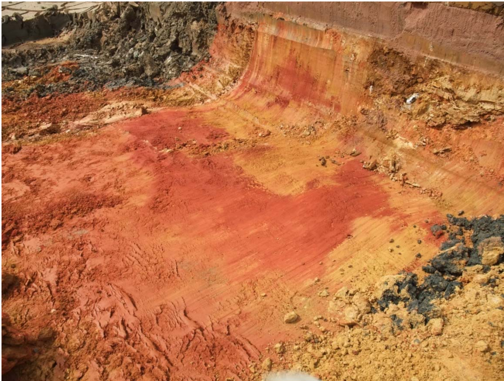
Bild 31: Aushub -2,3 m: weiterhin kreidezeitliche Sedimente (S,u´t´ und U,s,t´) in der gesamten Aushubebene
