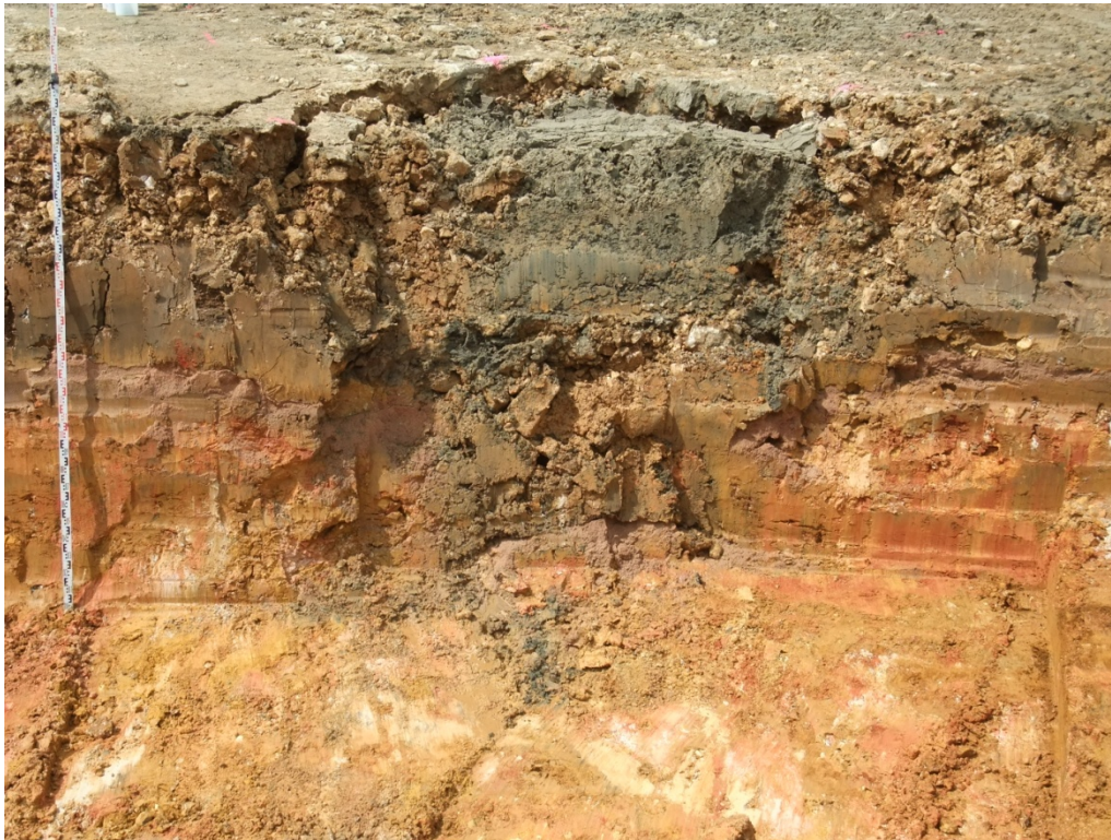
Bild 39: Aushub -2,7 m, Ansicht Einbruchtrichter 17 im Anschnitt
