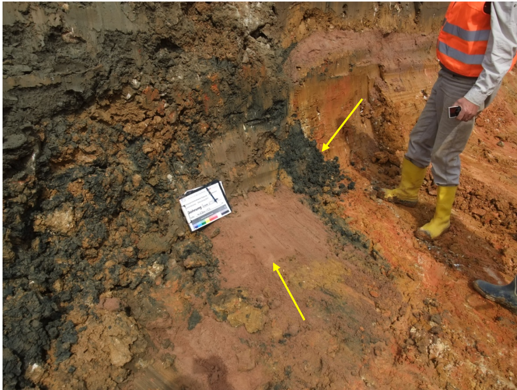
Bild 33: Aushub -2,3 m, nördlicher Rand Einbruchtrichter 3: mitgerissener Teil Beckensediment (rechter Pfeil), Filtersand im Einbruchtrichter in Höhe des Aushubniveaus
