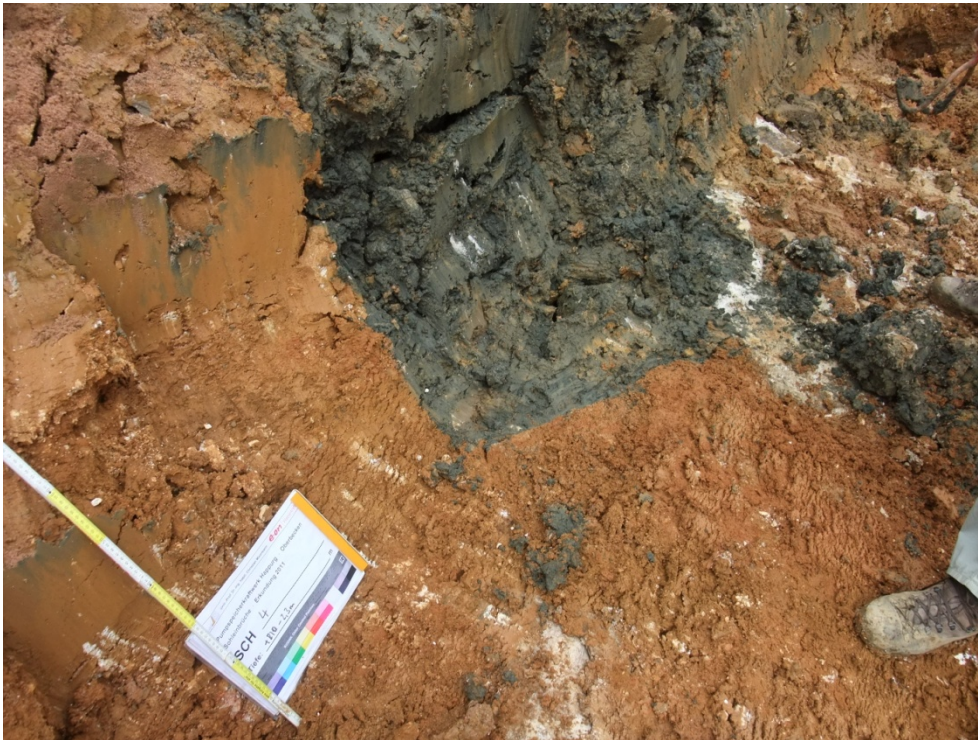
Bild 17: Detailaufnahme vom Einbruchrichter 4: dunkle weiche organische bindige Böden im Einbruchbereich im unmittelbaren Kontakt zu Lockergesteinen und Kalkstein
