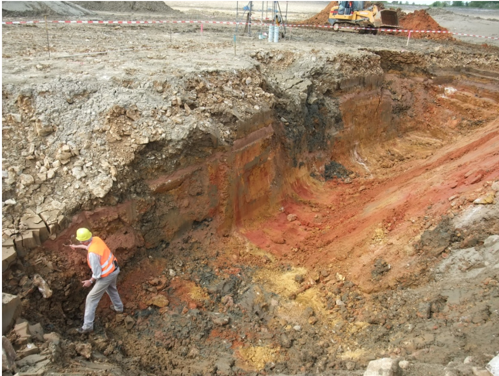
Bild 51: Vertiefung des Schurfs auf rund 4,0 m, im Vordergrund nördlicher Rand Einbruchtrichter 1, dahinter Einbruchtrichter 3 und 17, überall kreidezeitliche Sedimente
