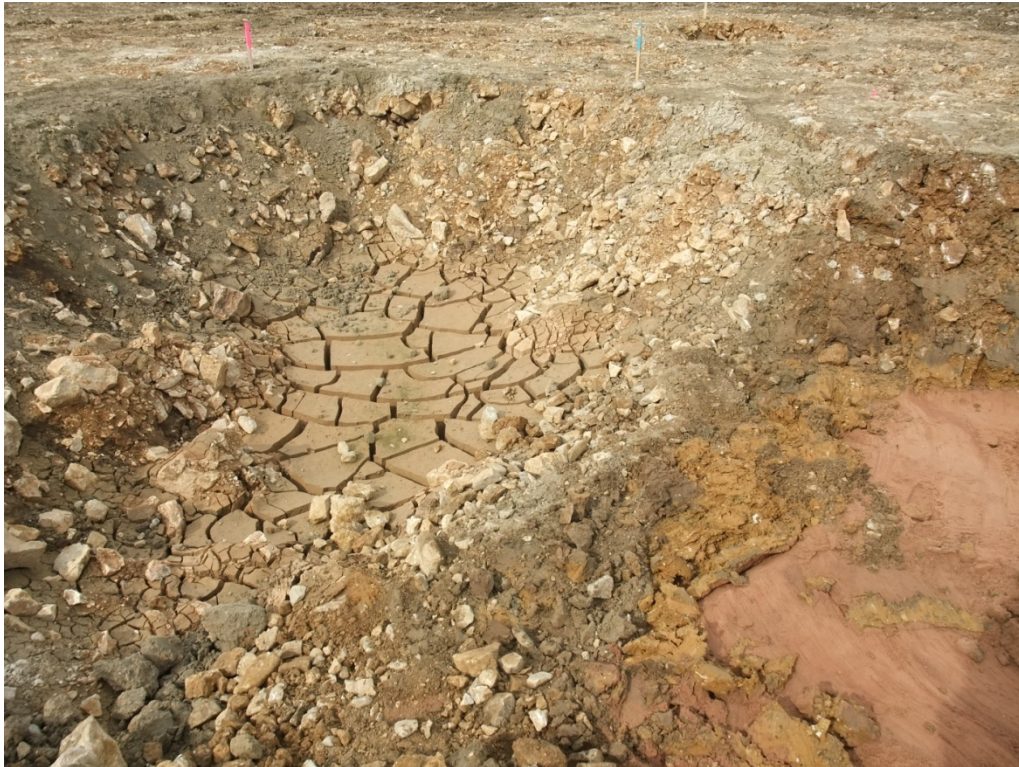
Bild 19: Beginn Freilegung Einbruchtrichter 1: randlich scharfer Übergang zwischen umliegendem Filtersand zu eingebrochenen Lehmdichtung und Schutzschicht
