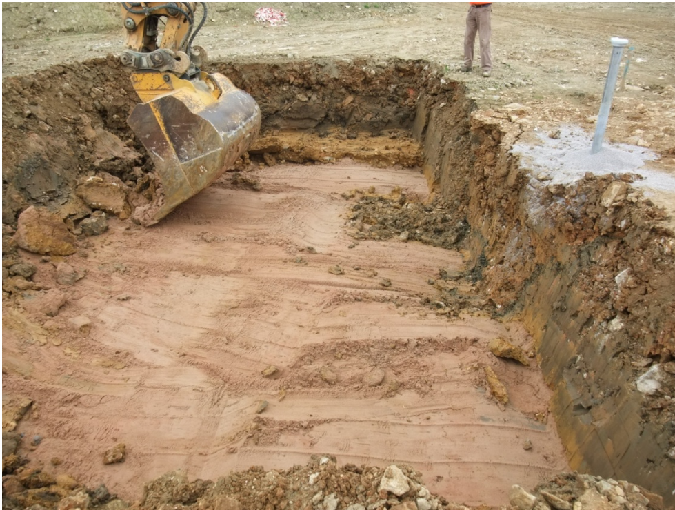
Bild 5: Schurf nach Abtrag der Lehmdichtung, in der Basis der rötlichbraune Drainagesand, rechts die BK 34/2011 und der sich im Drainagesand abzeichnende Einbruch
