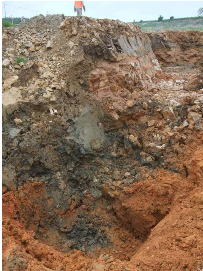
Bild 33: auf knapp -6 m unter Beckensohle vertiefter Schurf am Einbruch 2
