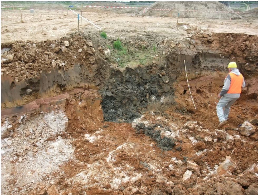
Bild 20: Anschnitt Einbruch 4: kleinräumig wechselnde Abfolge von Kalksteinformationen und Lockergesteinen unter Beckensohle
