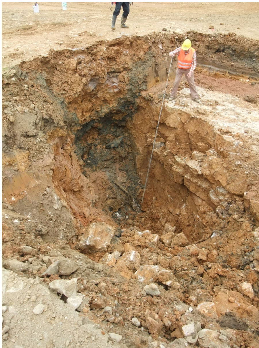
Bild 17: Aushubniveau -5,0 m: dunkles weiches bindiges Material (Beckensediment?) im Einbruchtrichter bis zur Endtiefe des Großschurfes
