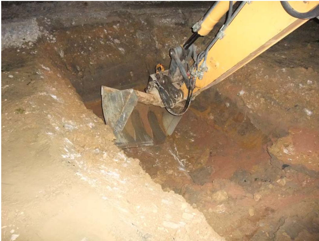
Bild 3: Kalkstein ab 1,4 m unter Beckensohle: mit Baggerschaufel nicht lösbar
