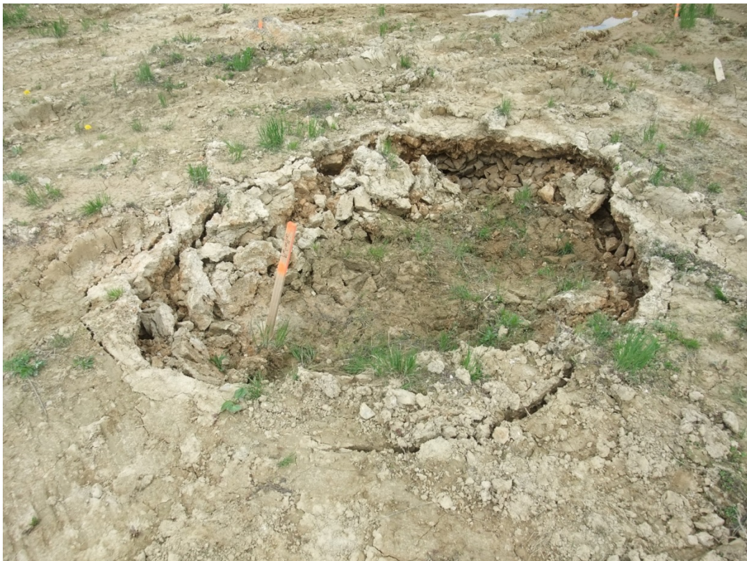
Bild 5 Einbruch in der Beckensohle im Bereich der Vollbohrung G150-W9 am 29.04.2013. a) Lage des Einbruchs; b) Foto vom 29.04.2013
